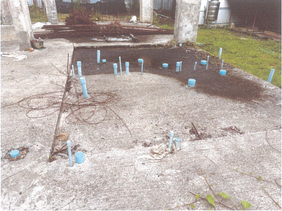
ภาพตัวอย่างอาคารส่วนต่อขยายโรงงานต้นแบบแสดงส่วนที่ได้มีการดำเนินการวางท่อระบบสุขาภิบาลที่ฝังกับพื้นคอนกรีตอาคาร ชั้น ๑
