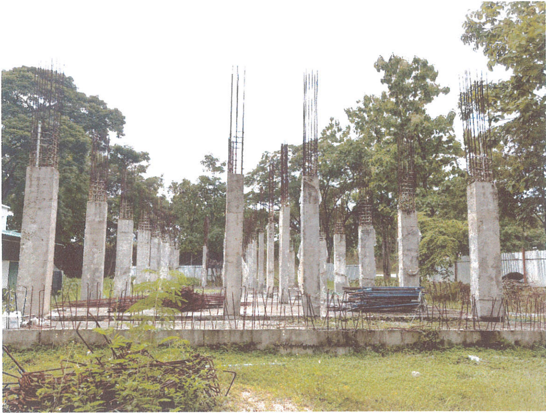
ภาพ ตัวอย่างอาคารส่วนต่อขยายโรงงานต้นแบบแสดงส่วนที่ได้มีการดำเนินการแล้ว (ภาพด้านข้าง)
